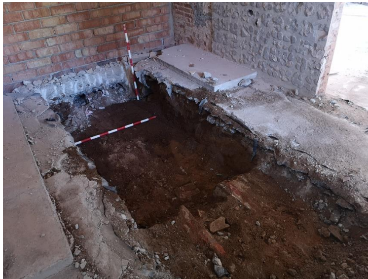
Figura 10. Zanja 1: Inicio de los trabajos y vista general de las conducciones previas i los rellenos
